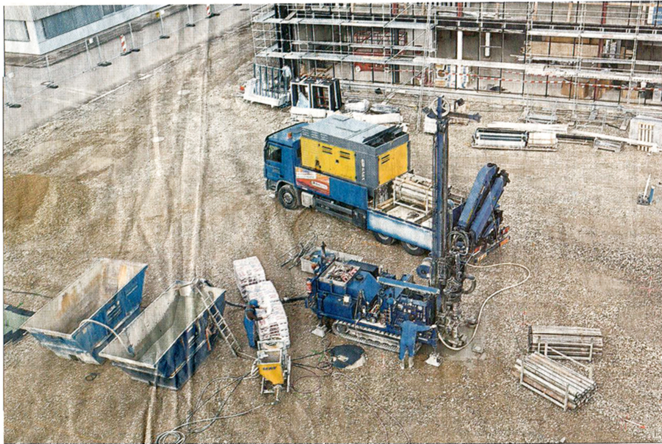
Für Wasser/Wasser-Wärmepumpen ist eine Brunnenanlage mit Förder- und Schluckbrunnen notwendig. Hier eine mobile Bohranlage im Einsatz für ein Bauvorhaben in München. FOTO MAX WEISHAUPT GMBH
